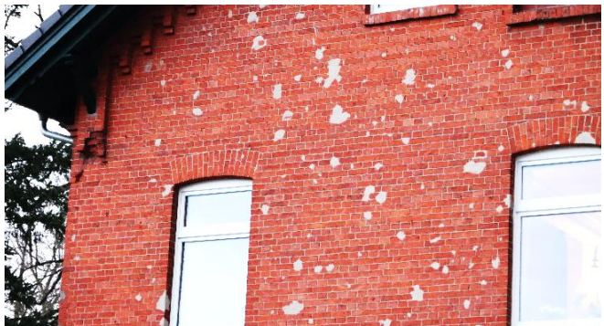
Noch heute sichtbar: Einschüsse des Zweiten Weltkrieges; die großen Einschusslöcher wurden zugemauert
